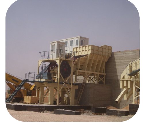
Bunker ve Besleyiciler
